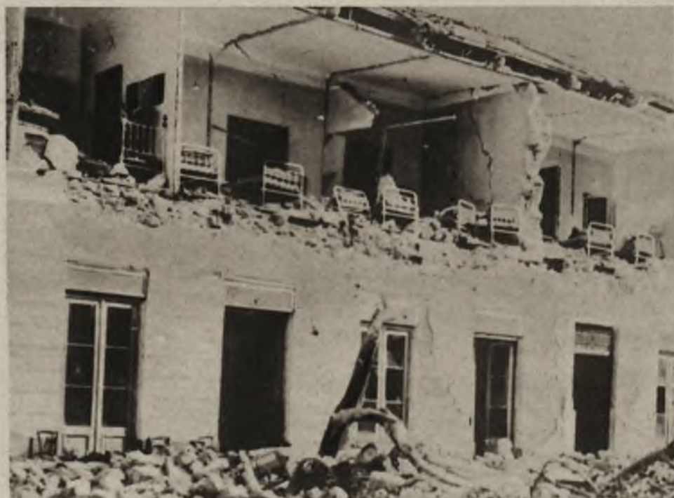
Zdjęcia z trzęsienia ziemi w Grecji. Na lewo: Dom w Koryncie, od którego odpadła jedna ściana odsłaniając wnętrze. Na prawo: Miasto namiotów, w którym schronili się bezdomni mieszkańcy, uległo wkrótce także zniszczeniu przez orkan i trzęsienie ziemi.
