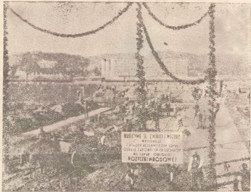
W Gdyni prowadzone są prace przy budowie ulicy Żwirki i Wigury. Prace wykonuje Związek Rezerwistów w Gdyni, który oddaje zarobki swych członków na zakup obligacji Pożyczki Narodowej.
