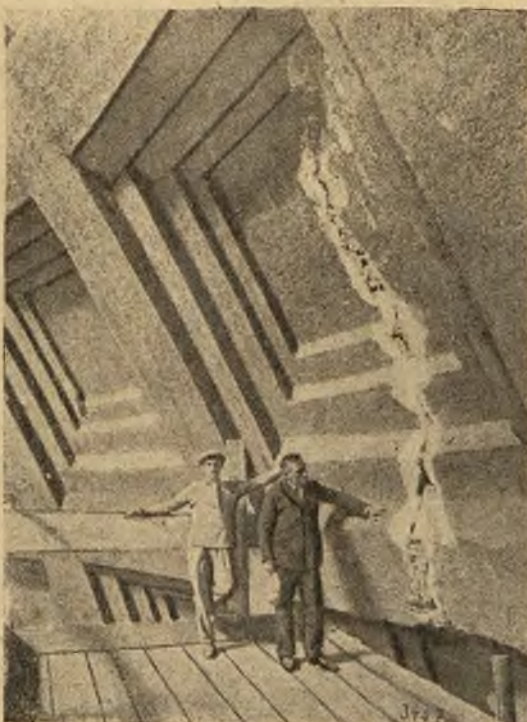
Panteon w Rzymie, jedna z najciekawszych starych budowli „wiecznego miasta“, zarysował się poważnie. Ryc. przedstawia szczelinę.
