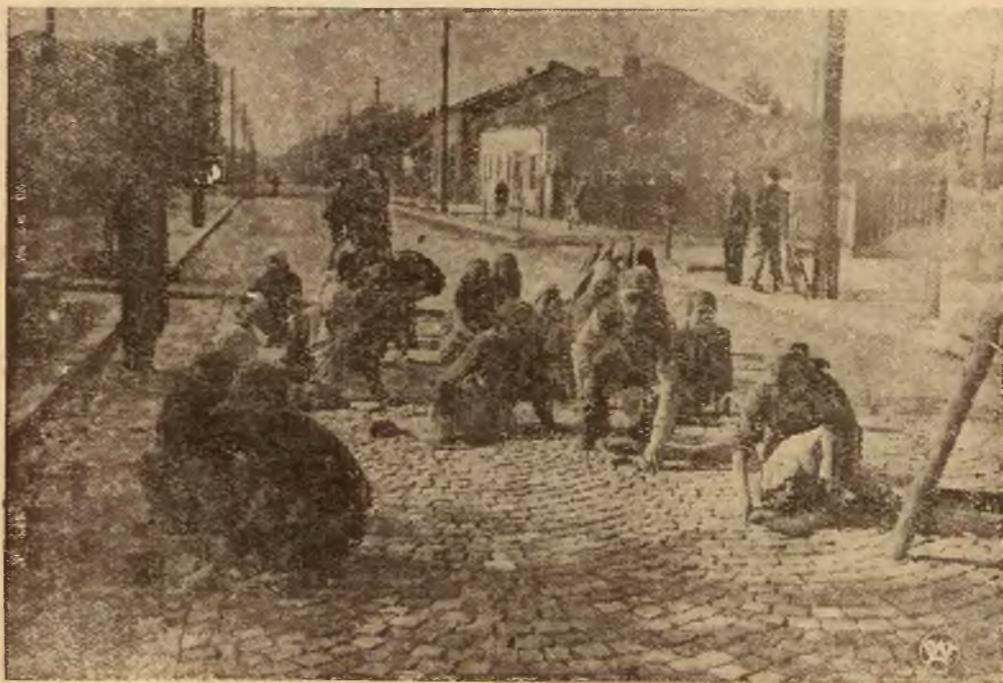
Budowa nawierzchni z kostki granitowej szosy budowanej w Krzeszowicach z zasiłku Funduszu Pracy.
