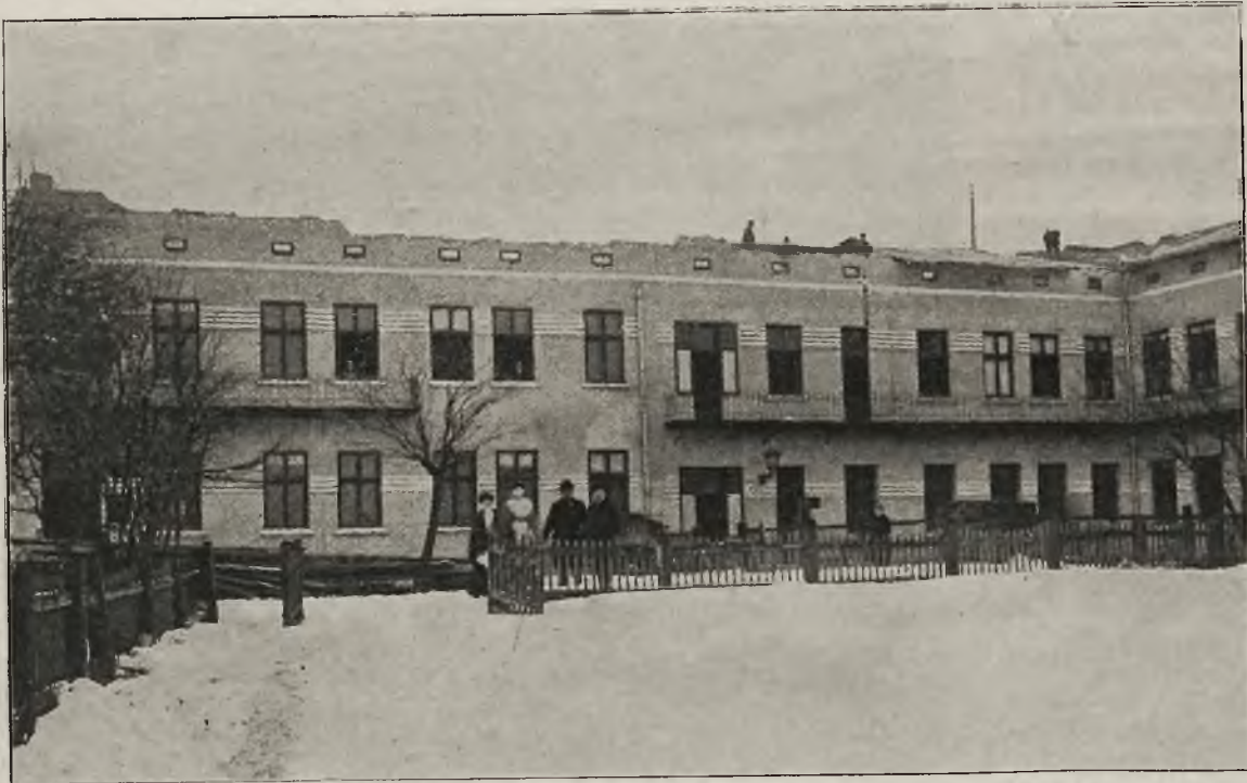
Ofiary orkanu: Widok nowego gmachu pocztowego w Drohobyczu, z którego wicher zerwał dach z więzaniem.
