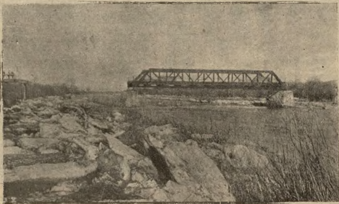
Fatalne skutki wiosennych roztopów: Resztki, pozostałe z żelaznego mostu pod Gólkowicami za Starym Sączem. Fot. Bracia Dworzak, Nowy Sącz.
