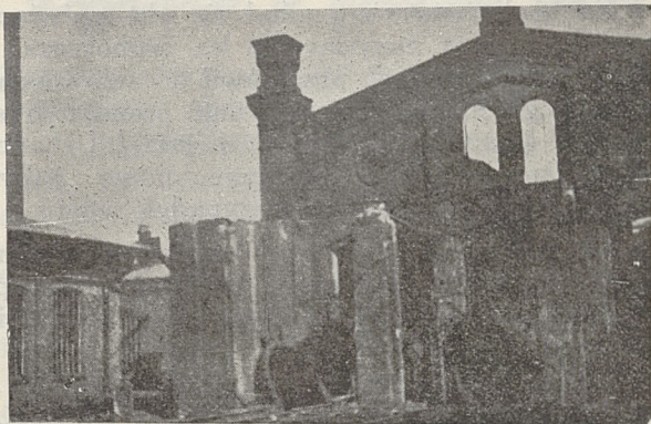
Część obiektu spalonego podczas pożaru w W. Chelmie. Na przedniej części kotły, gdzie wybuchł pożar.
