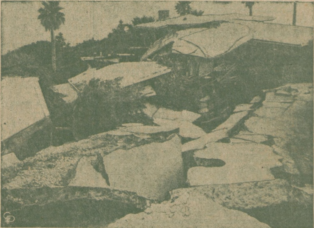
TAK WYGLĄDAJĄ skutki obsunięcia się ziemi 10 do 15 stóp w Pacific Palisades, Calif., zniszczeniu uległy trzy luksusowe domy, zagrożeniu szereg innych.
